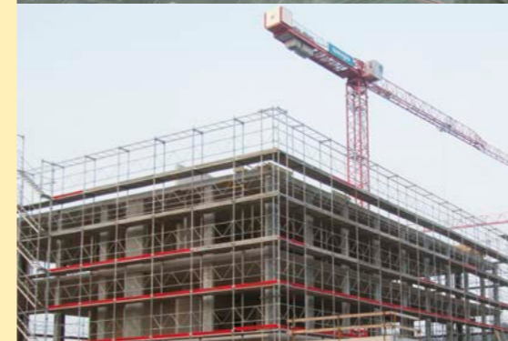
September: Die beiden Vollgeschosse des Büro-Labor-Gebäudes sind fertig errichtet. Darauf folgt noch ein Aufbau, insbesondere für technische Einrichtungen.
