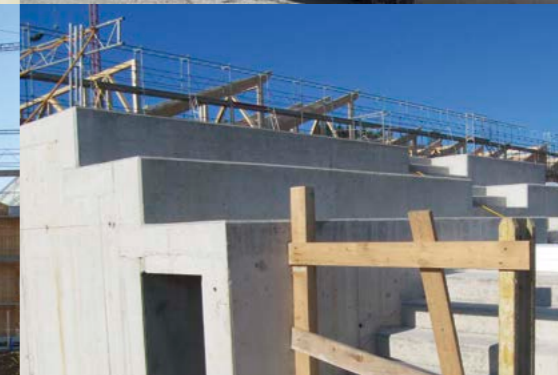
November: Gegen Ende Jahr ist die Bodenplatte des Forums fertig, inklusive Tribünen. Alle Kommunikationsleitungen laufen hier sternförmig zusammen.
