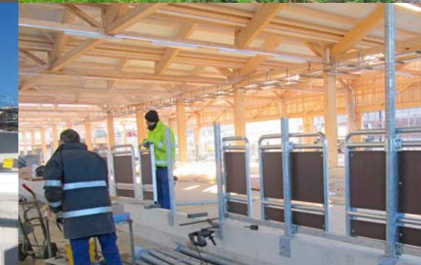
Dezember: Im Milchviehstall werden die Stalleinrichtungen eingebaut. Ende Februar 2017 sollen die Kühe der ETH-Herde eingestallt werden.
